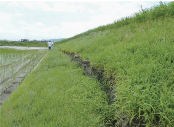
図7 矢部川の堤防で確認された亀裂。(国土交通省提供)
