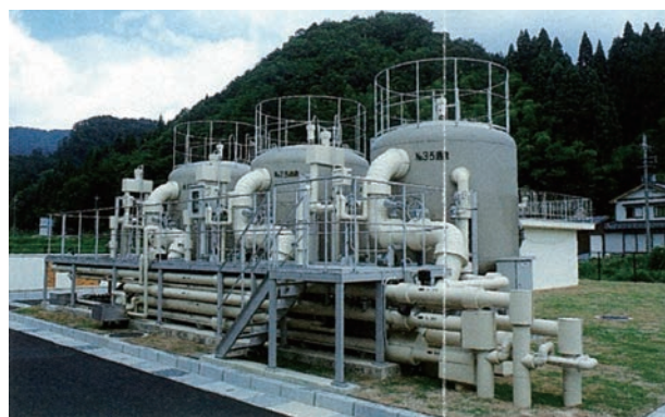
図5 稲葉浄水場 塩化第二鉄ヒ素除去施設。 豊岡市 稲葉浄水場(豊岡市のパンフレットから)。
